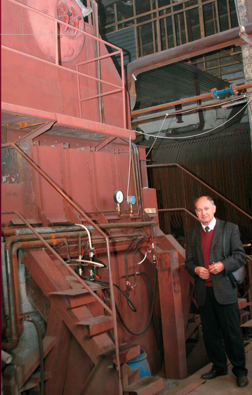
Одна из парогенерирующих установок малой мощности на водоугольном топливе успешно работает на заводе стеновых блоков (СИБИТе) в Новосибирске. Водоугольное топливо и воздух подаются в топку котла по трубопроводам в автоматическом режиме. Рядом с установкой – д. т. н. Л. И. Мальцев (ИТ СО РАН). Фото М. Роговой
